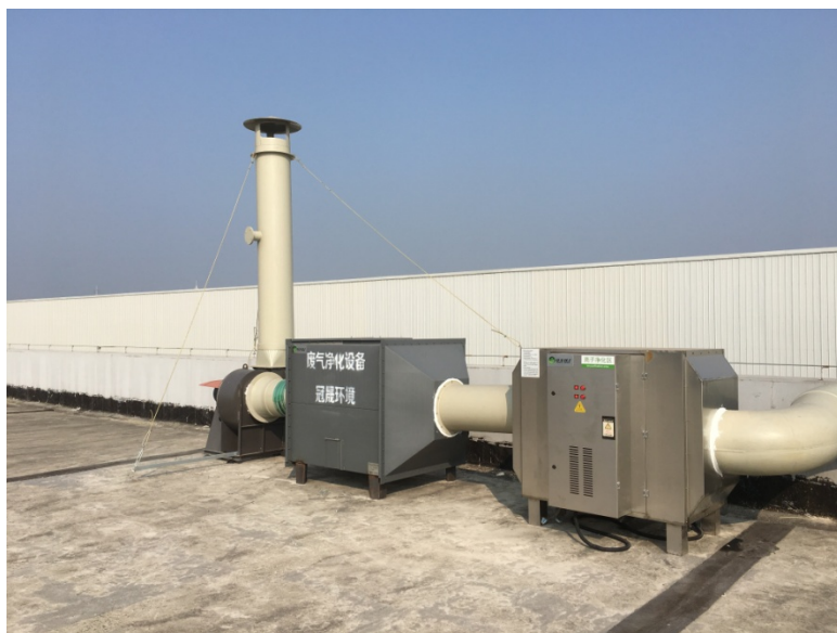
图 3-3 废气治理设施图
